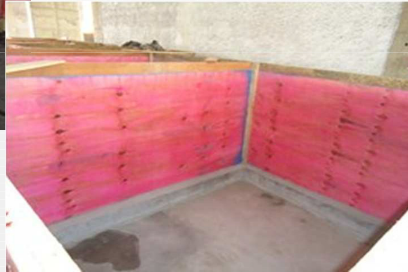
Baias com mureta de contenção interna, para conter resíduos na área e evitar contaminação de solo.
