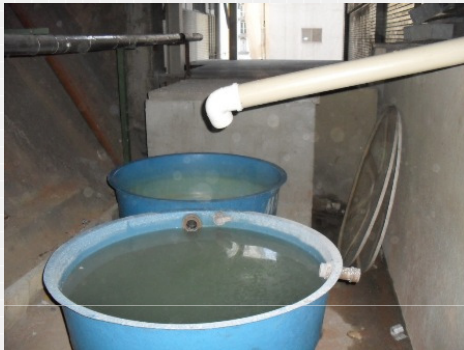
Caixa de Decantação resíduos de corte
